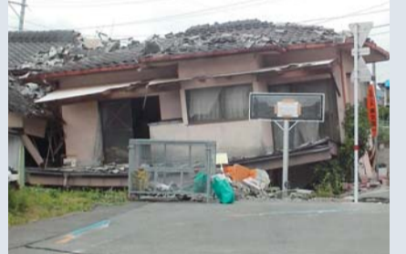
熊本地震で被災した建物
