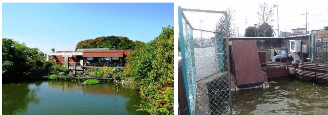
写真 3 水質浄化施設および水循環施設（左：水質浄化センター、右：循環ポンプ取水口）
