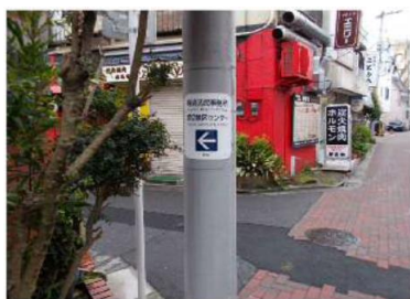
電柱を利用した添架
