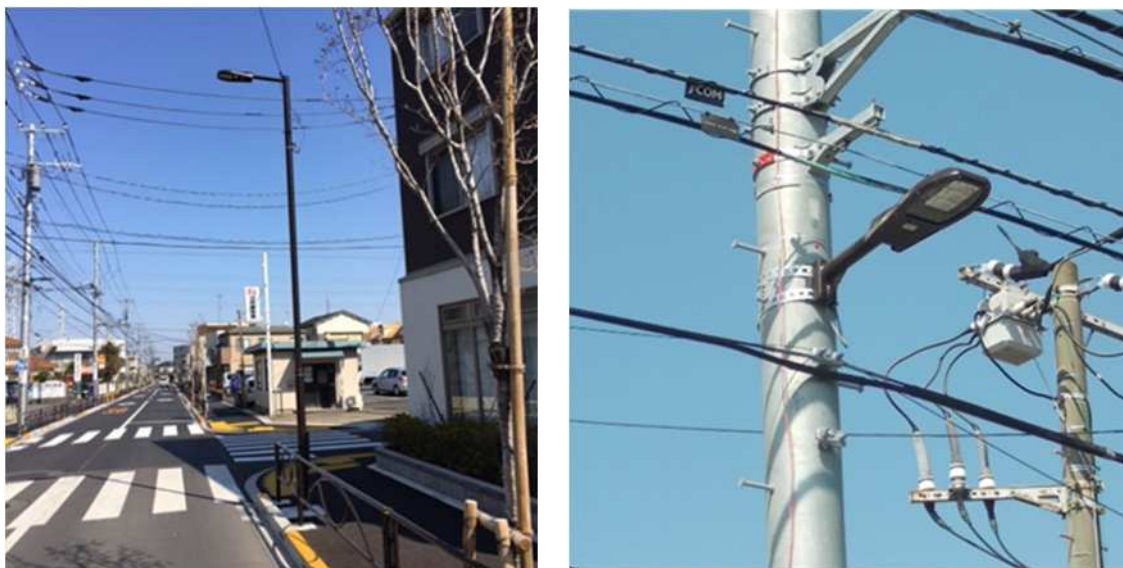
写真 2-9 街路灯 (左:灯柱式、右:共架式)
