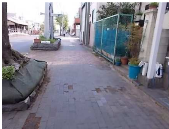
写真 3-3 損傷状況の例（ランクII）
