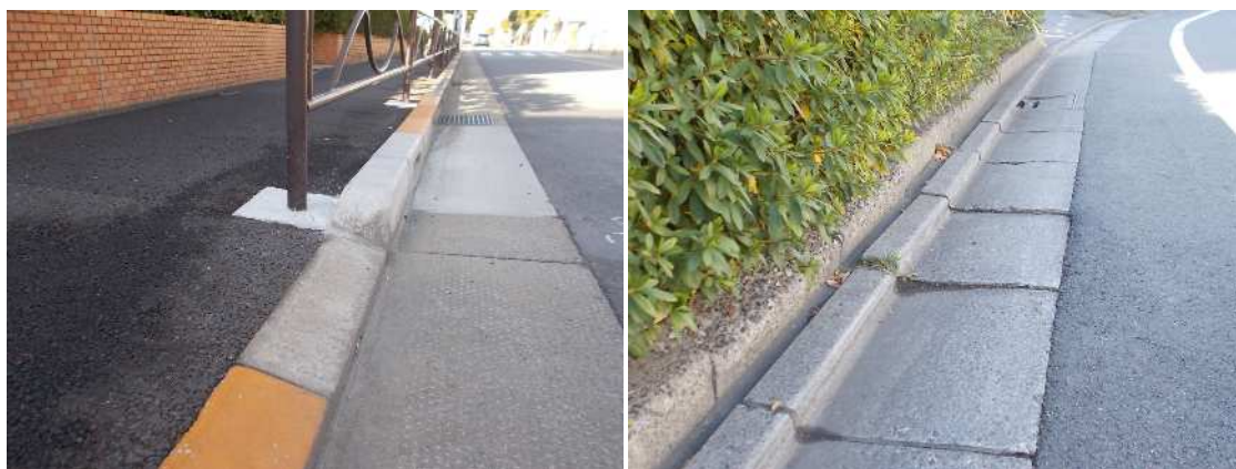
写真 2-5 排水施設（左：街渠、右：L 形側溝）
