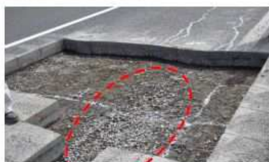
路盤の損傷の例 (路盤の細粒分がボンピングにより 流失し、碎石が集まっている状況)
